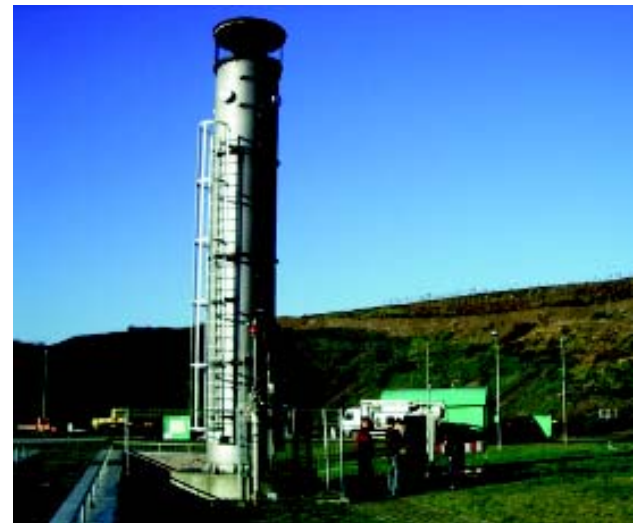
Blick auf eine Fackel zur Hochtemperaturverbrennung von Deponiegas
