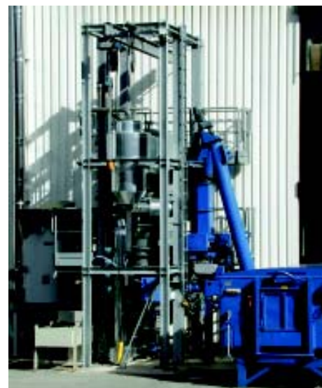
Wirbelschichtvergasungsanlage am Standort Oberhausen
