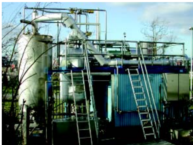
Rohrleitungsversuchsfeld bei Fraunhofer UMSICHT
